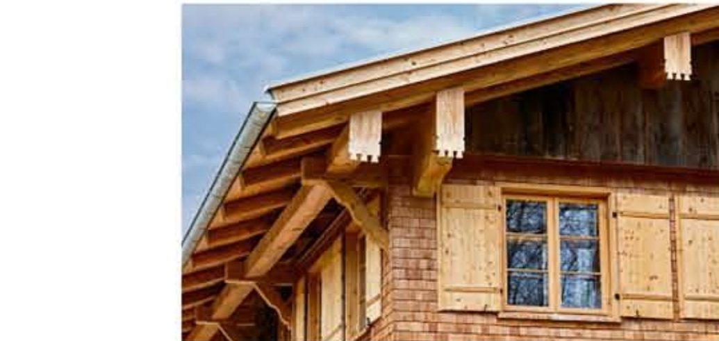
Allgäuer Spezialität: Die Fluggfette. Für mehr Dachüberstand im Süden wird die letzte Pfette verdoppelt. Der Bauschmuck stammt aus dem Ausbau Mitte des 19. Jahrhunderts.
