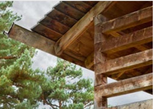
Die geschuppte Schalung aus Lärchenbohlen als kostengünstige Dachhaut muss nach Jahrzehnten einfach wieder erneuert werden. Auch die Dachrinnen sind aus Brettern gefertigt, in die ein V-förmiges Kupferblech eingelegt ist.
